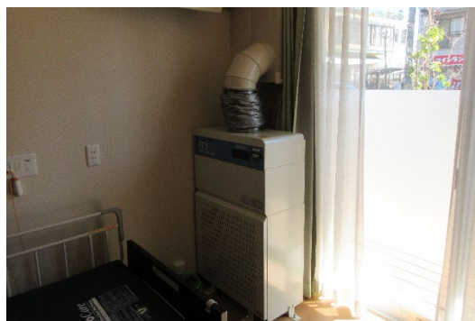
すべての居室内に取り付けられた陰圧装置
